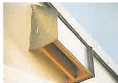
Detailansicht der Nistkästen am Personalwohnheim: Für Alpensegler, Mauersegler, Fledermaus u. a. wurden hier zahlreiche Nisthilfen geschaffen.
